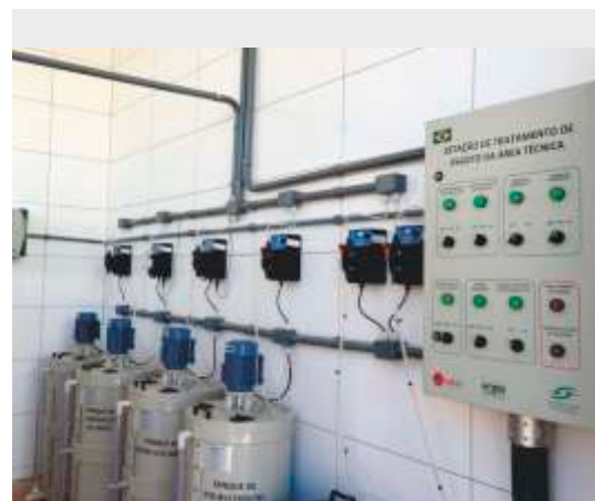
Estação de tratamento de esgoto na nova sede do Sabesp, Brasília-DF.
